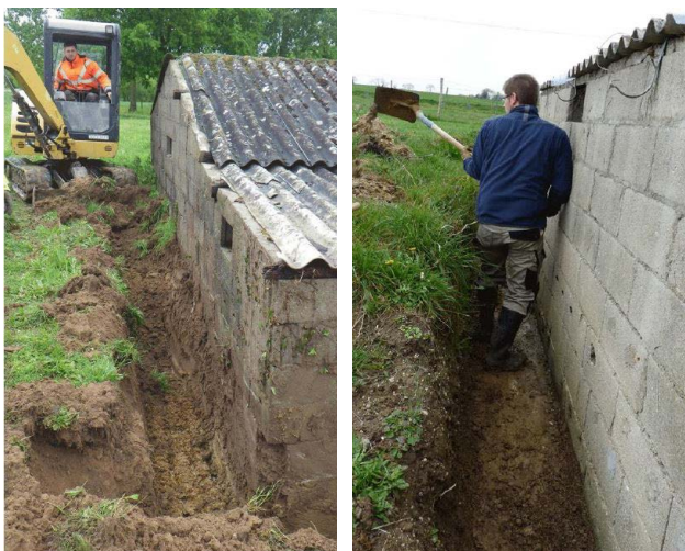
FIGURE N°4 : DEGAGEMENT DES FONDATIONS À L'AIDE D'UNE PELLE MÉCANIQUE ET FINITIONS À LA PELLE A MAIN
