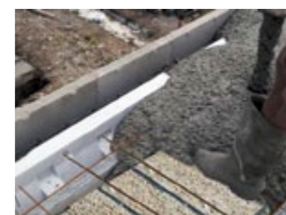
▲ La dalle de compression est arasée à la face supérieure des Isorupteurs.
