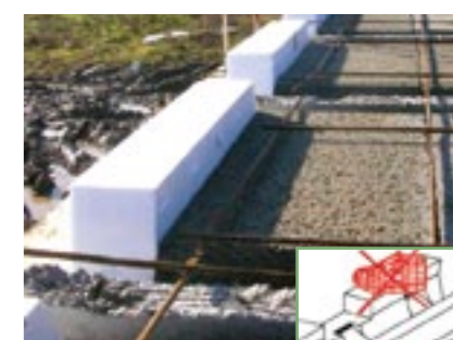
▲ 9 - Coulage de la dalle à l'arase des Isorupteurs HB60 Ne pas marcher sur les Isorupteurs.
